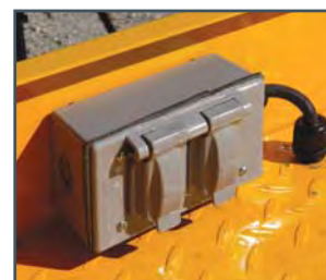
Prises 110 volts à la plateforme
